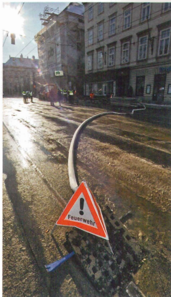
Rohrbruch. In Wien-Alsergrund brach Mitte Juni ein Hauptwasserrohr: Haushalte waren stundenlang ohne Wasser.
